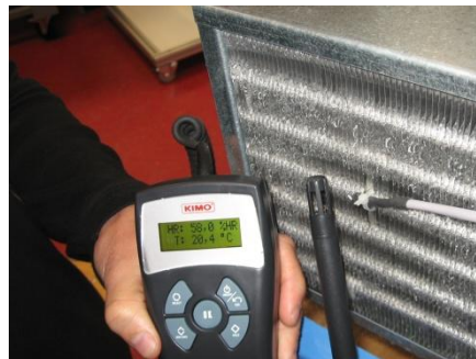
Mesure à l'entrée de l'évaporateur
