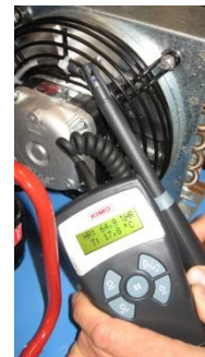
Mesure en sortie de l'évaporateur
